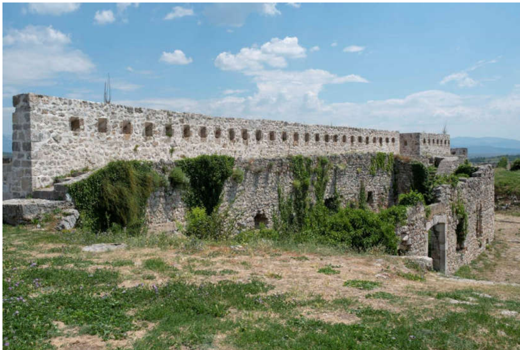
19 – Gornji grad, istočni obrambeni zid i urušena zgrada vojarne
