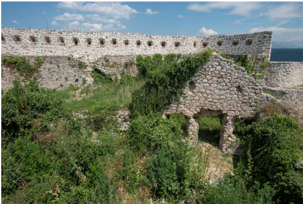
27 – Gornji grad, pogled sa zapada na urušenu zgradu u južnom dijelu
